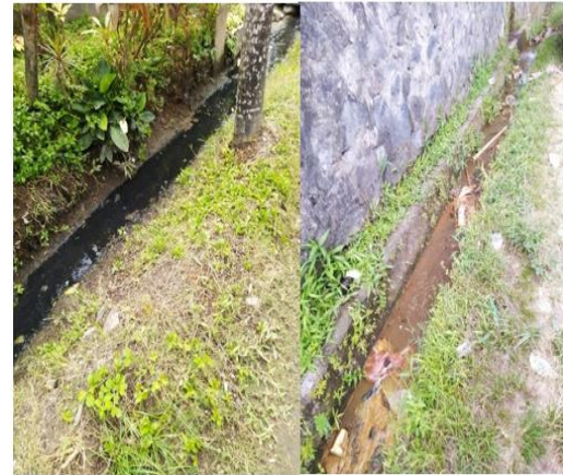
Gambar 1. Kondisi saluran eksisting di lapangan
