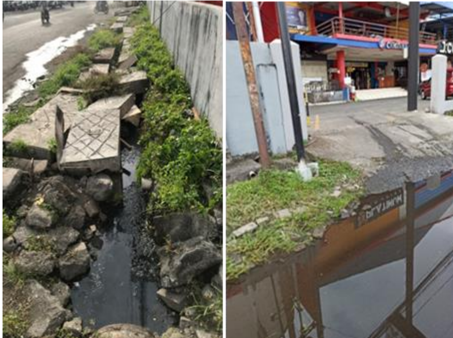
Gambar 2. Kondisi Saluran Eksisting
