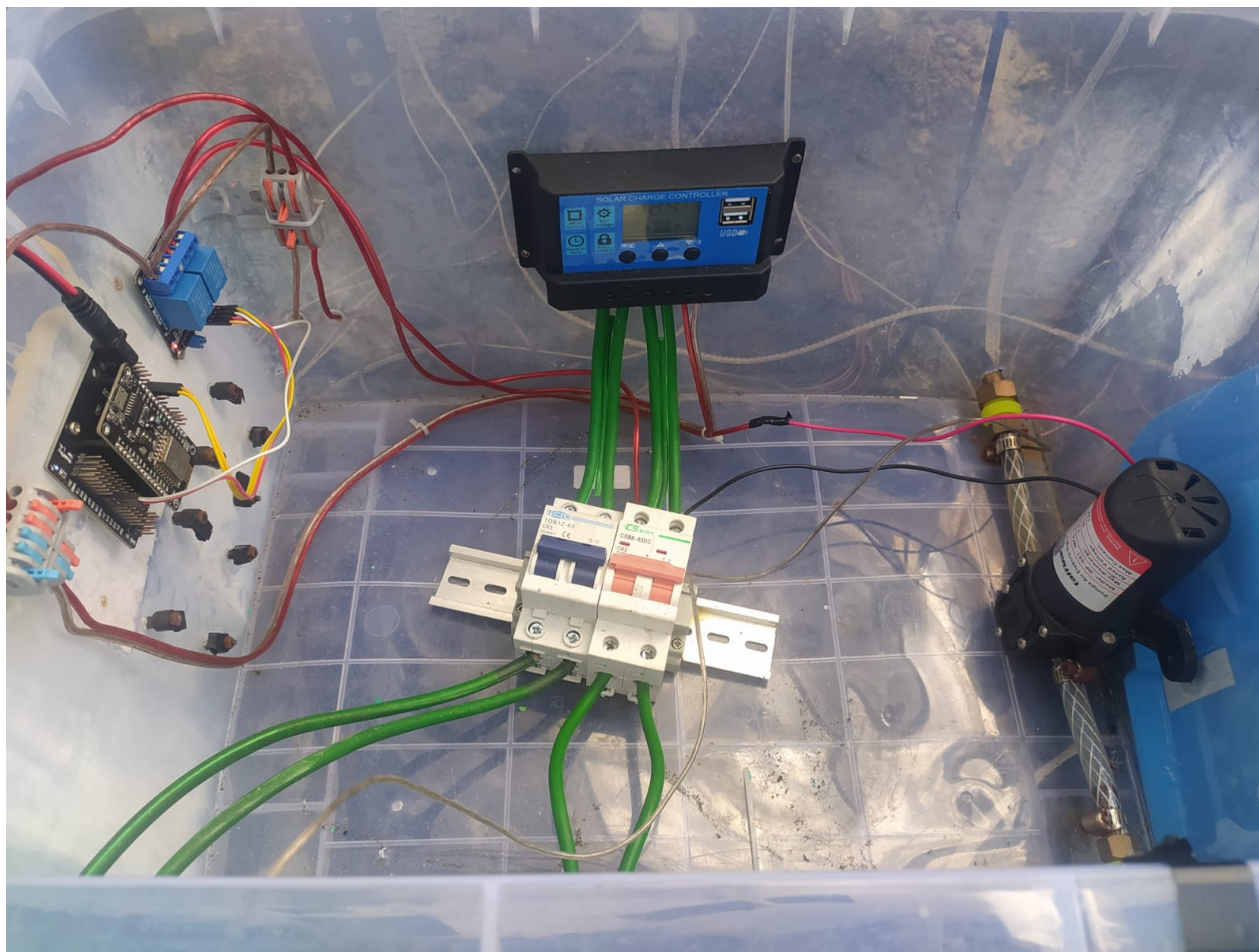
Gambar 4. Kotak kendali sistem smart green house .
