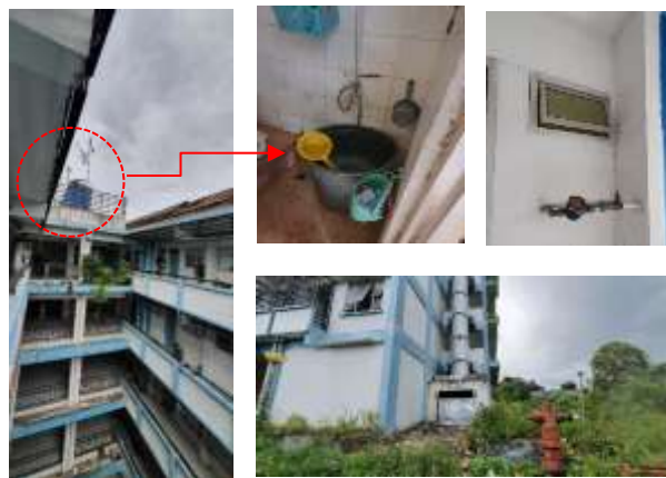
Gambar 11. Utilitas Rumah Susun Sewa Cakalang di Bitung.
