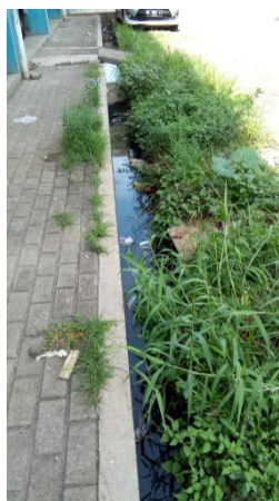
Gambar 4.8 Drainase Rusunawa Tingkulu Sumber: Dokumentasi Peneliti
