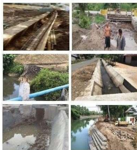
Gambar 4. Kondisi Ketersediaan Bangunan Pengendalian Banjir
