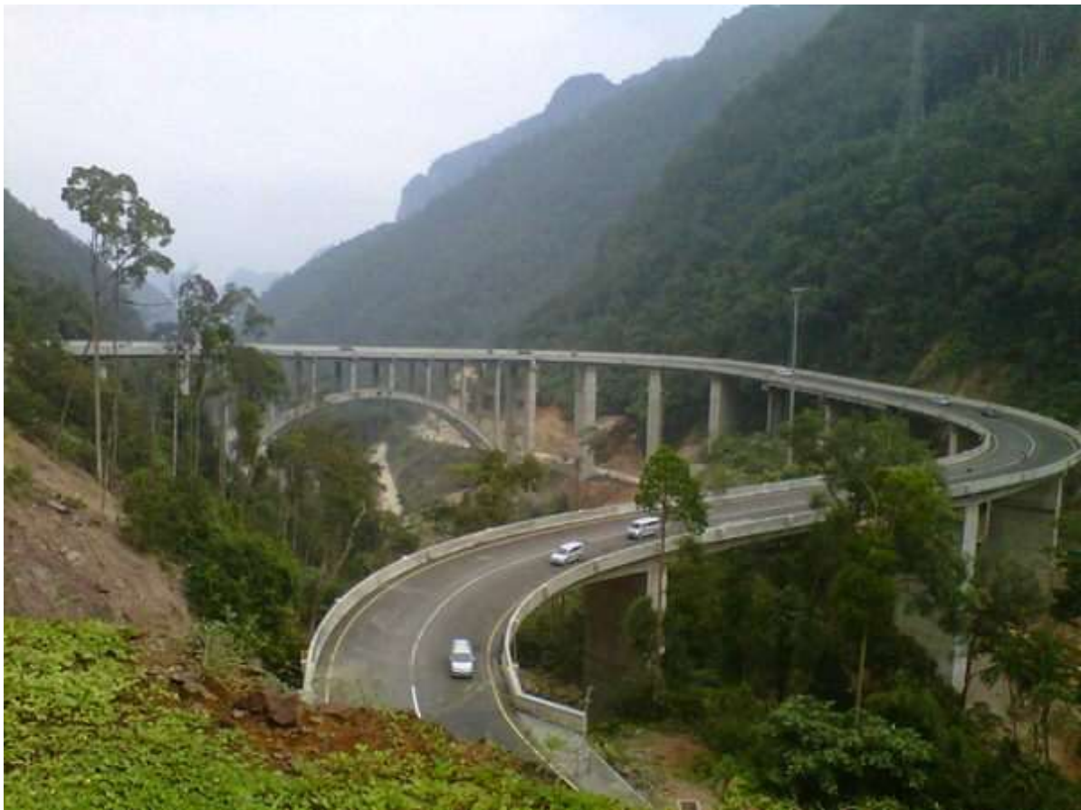
Gambar 8. Struktur penahan tanah yang mumpuni untuk menahan lereng di atas dan di bawah jalan. Sumber : ruas Jalan Kelok Sembilan, 2014.
