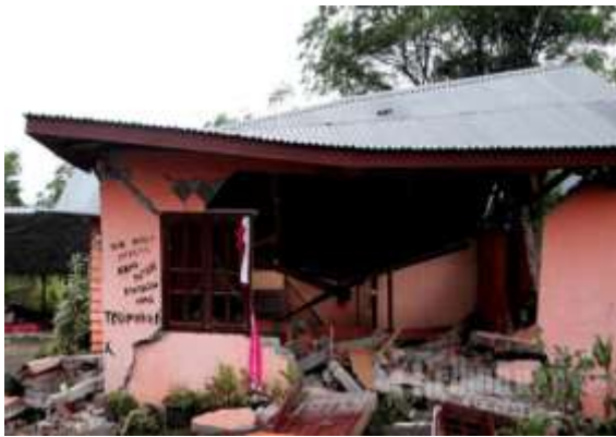
Gambar 1. Kerusakan dinding pada rumah sederhana akibat gempa
