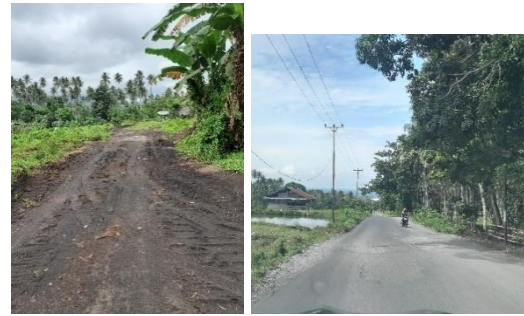
Gambar 3. Kondisi Jalan di Kecamatan Kema dan Kauditan
