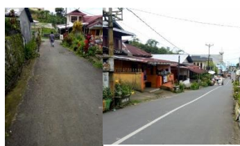
Gambar 10. Kondisi Jalan tahun 2019
