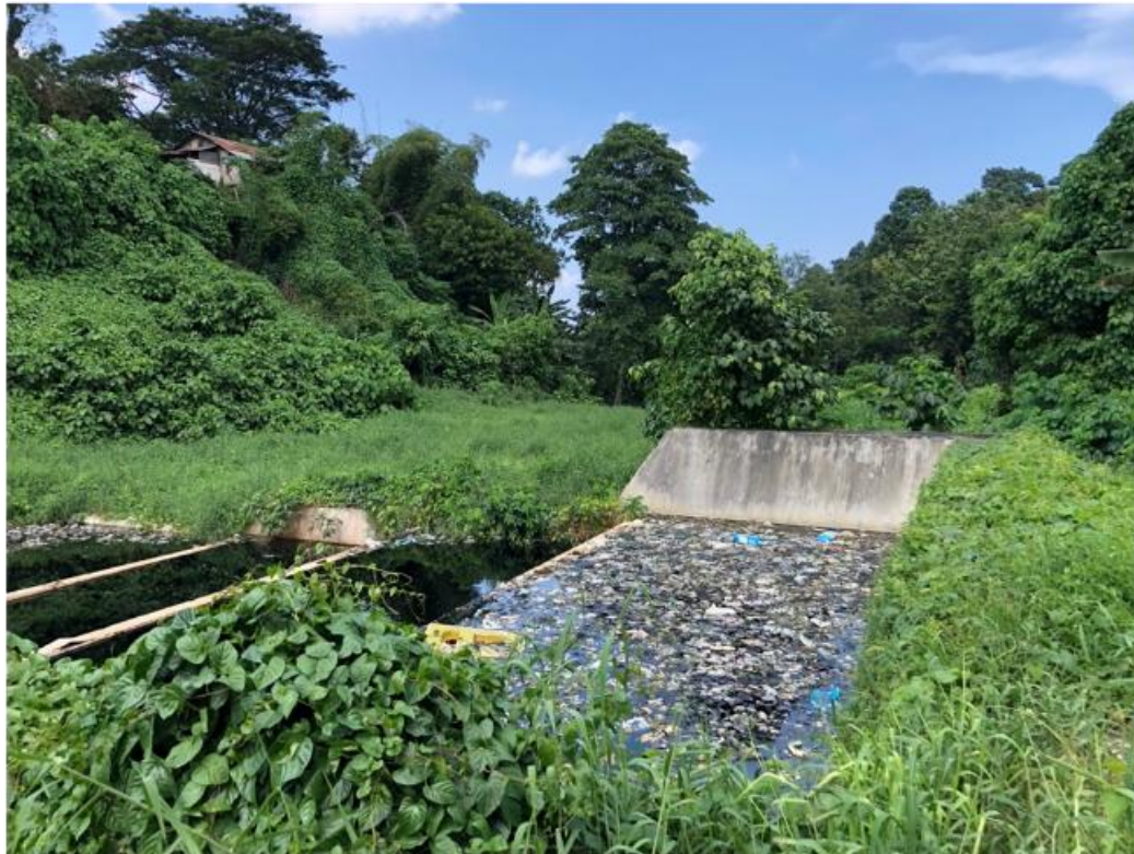
Gambar 3. Instalasi Pengolahan Lindi TPA Sumompo Sumber: Hasil Survei Lokasi Instalasi Pengolahan Lindi TPA Sumompo
