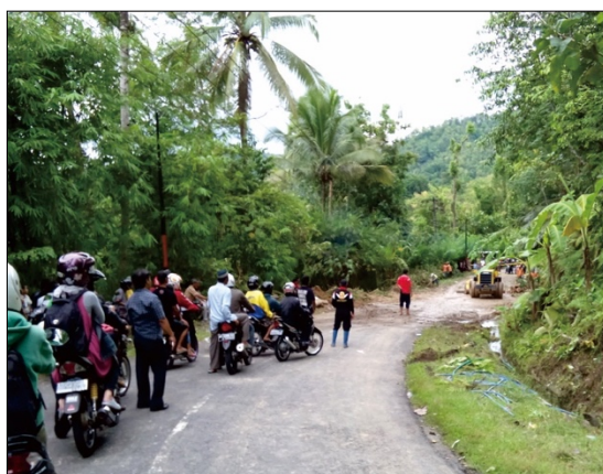
Gambar 2. Longsor yang terjadi di jalan raya Dekso-Samigaluh (Sumber: Dokumentasi pribadi, 2016)
