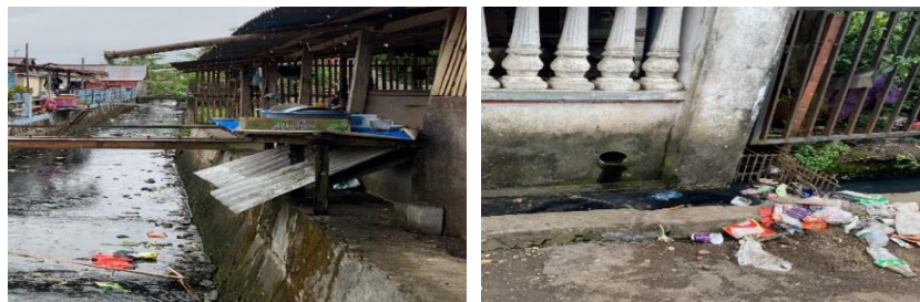
Gambar 5. Kondisi Drainase Lingkungan Kondisi Penelitian (Penulis, 2022)
