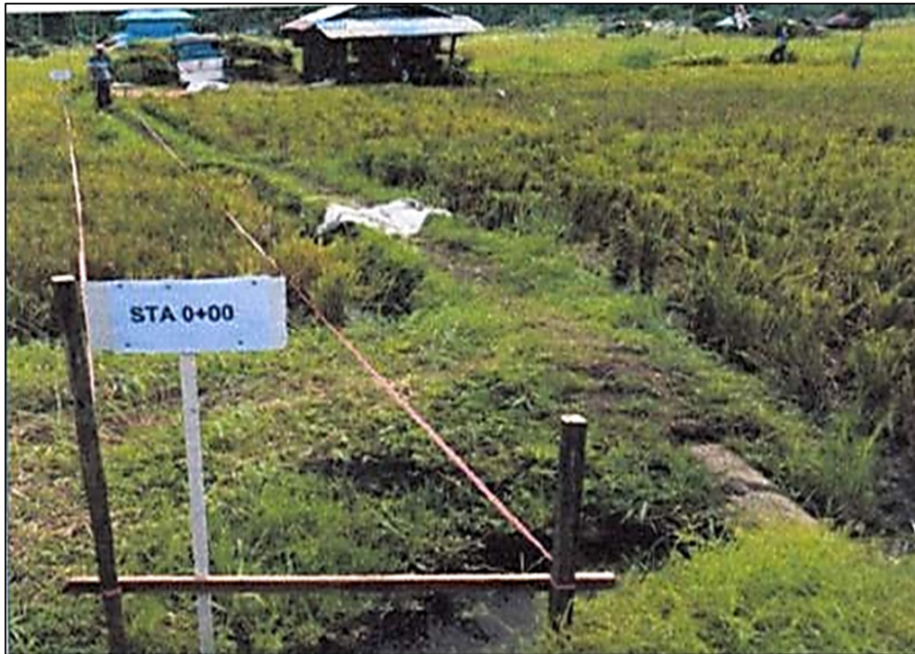
Gambar 3. Kondisi eksisting saluran irigasi desa
