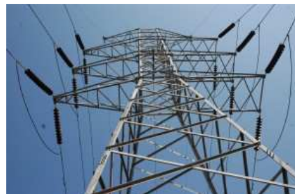
Gambar 3. Saluran Udara Tegangan Tinggi
