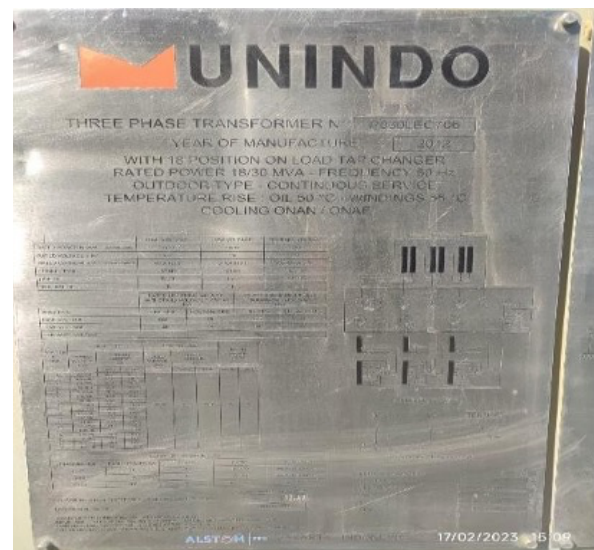
Gambar 2. Nameplate Trafo Daya Unit 1 GI Paniki
