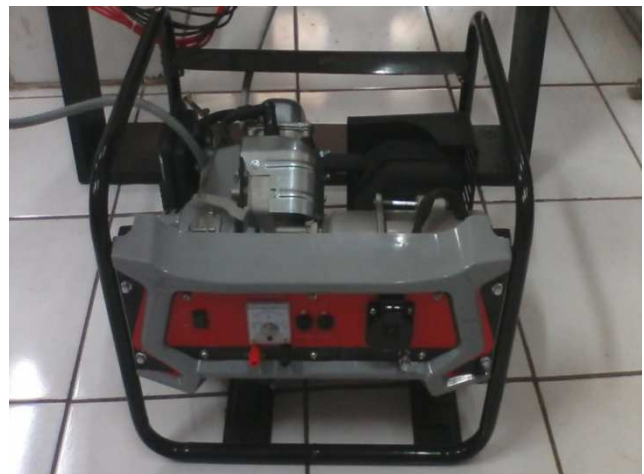
Gambar 10. Generator set untuk percobaan
