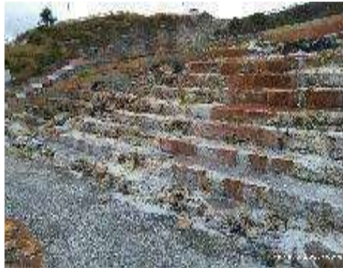
Gambar. Kerusakan-kerusakan Sarana
