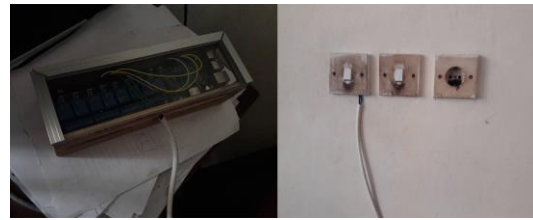
Gambar 18. Instalasi Sistem di Gedung B
