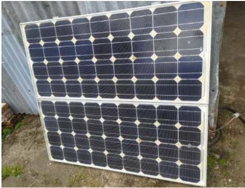
Gambar 14 Dokumentasi panel surya 80WP
