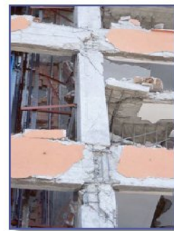
Foto 8 dan Foto 9. Kegagalan sambungan balok dan kolom
