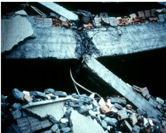
Foto 10. kekuatan balok lebih kuat dari kolom.
