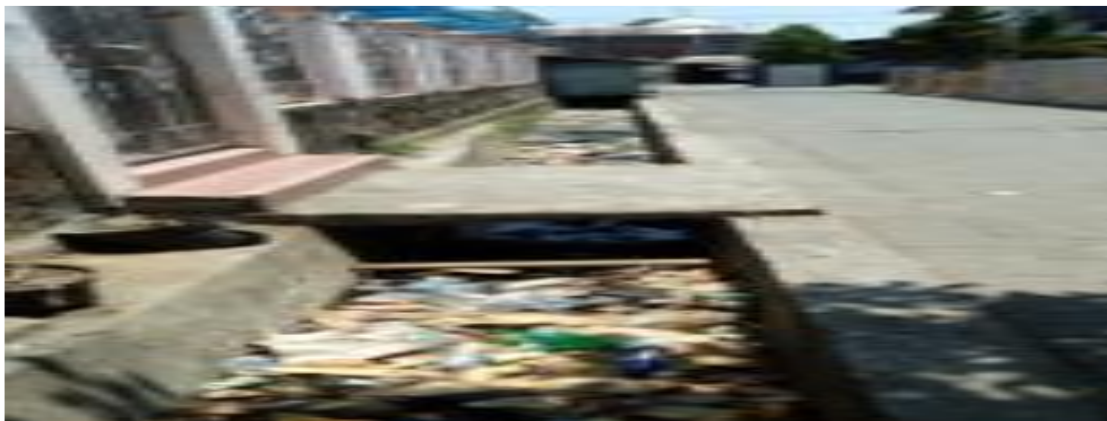
Gambar 4. Kondisi Saluran Drainase
