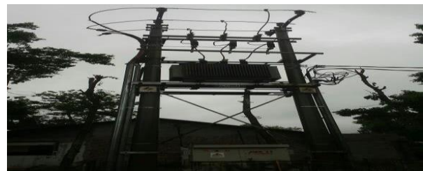
Gambar 3. Gardu Listrik di Kecamatan Langowan Barat
