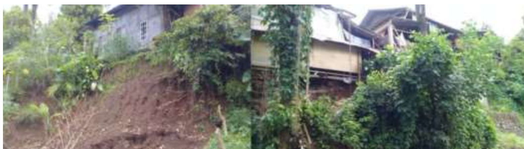
Gambar 4. Bangunan rumah penduduk terletak di kawasan perbukitan rawan yang longsor. Apabila tidak diwaspadai kemungkinan dapat mengancam korban jiwa dan kerugian harta benda penduduk.
