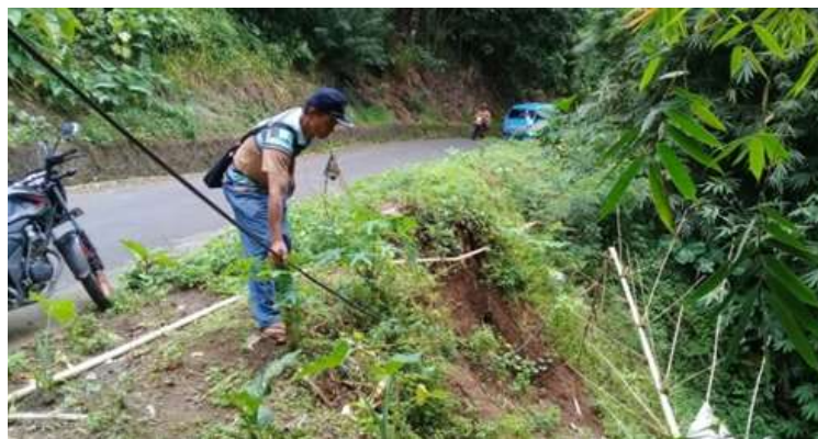
Gambar 5. Infrastruktur desa yang menghubungkan desa Kali dan desa Kali Selatan dengan pusat pemerintahan kecamatan maupun kabupaten yang terancam longsor karena berada pada tebing. Bila tidak ditanggulangi dengan pembuatan tanggul penahan tanah.
