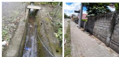
Gambar 5. Kondisi Drainase Tahun 2019
