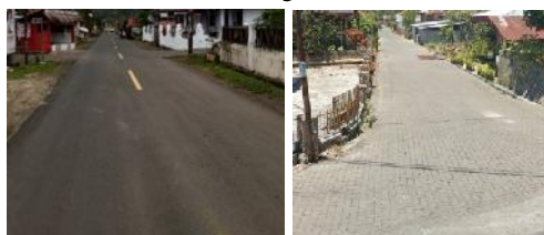
Gambar 3. Kondisi Jalan Tahun 2019
