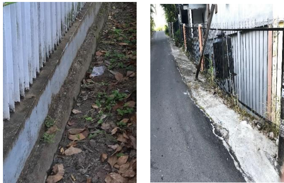
Gambar 1. Kondisi eksisting di lapangan dan kondisi ruas yang tidak memiliki saluran
