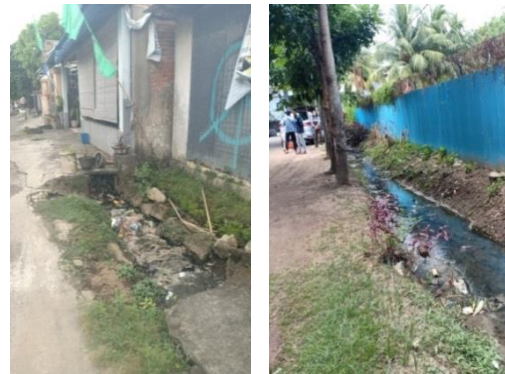
Gambar 5. Kondisi Eksisting Saluran Drainase
