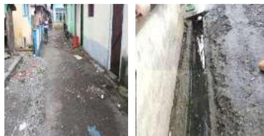
Gbr 1. Kondisi eksisting drainase
