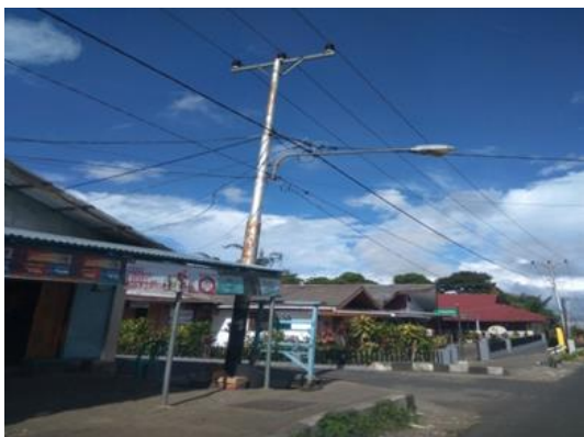
Gambar 11. Kondisi Jaringan Listrik Sumber : Penulis 2017
