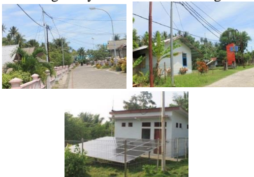
Gambar 7 Kantor PLN, Lampu Jalan, PLTS Sumber : Penulis 2018
