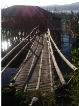
Gambar 0. 2 Kondisi Jalan Usaha Tani Sumber: Hasil Dokumentasi (Penulis, 2018)
