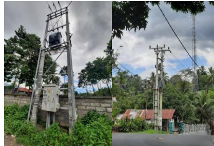
Gambar 22. Gardu Dan Tiang Listrik
