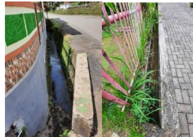
Gambar 6. Jaringan Drainase Kecamatan Pineleng Sumber : Survey Lapangan 2020
