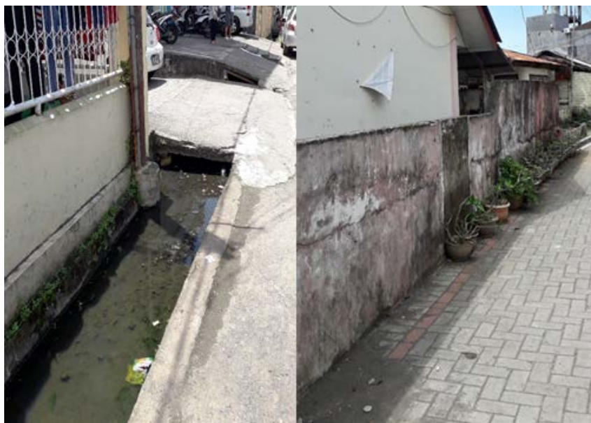
Gambar 1. Kondisi Eksisting Di Lapangan Dan Kondisi Ruas Yang Tidak Memiliki Saluran
