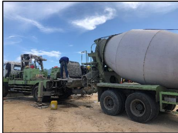
Gambar 12. Area Lokasi Truk Mixer
