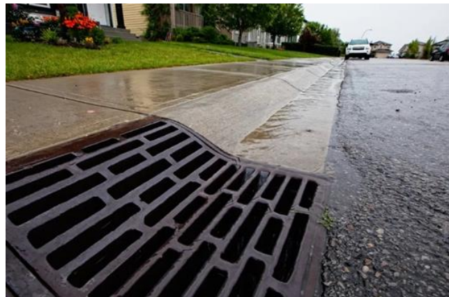
Gambar 2. Grill/Inlet Jalan Akses dan Trotoar (sumber: internet)
